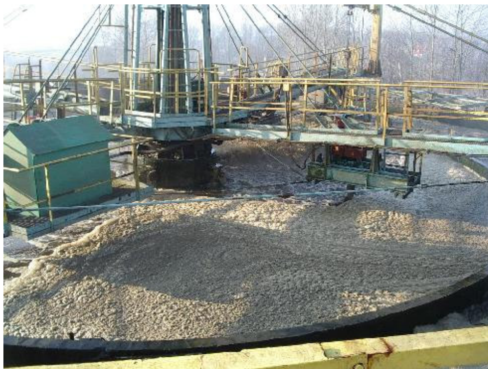
Rys. 2 Powierzchnia komory biostabilizacji w dniu 16 kwietnia 2003 r. z widoczną grubą warstwą osadu pływającego
